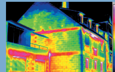
Thermografieaufnahme eines ungedämmten Gebäudes.
